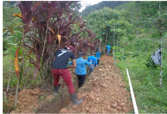
de dorpelingen (zij graven op deze foto een geul voor de hoofdleiding)
