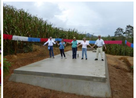
De grote distributietank in El Corozal
